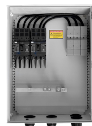
Skrzynka rozdzielcza AC
